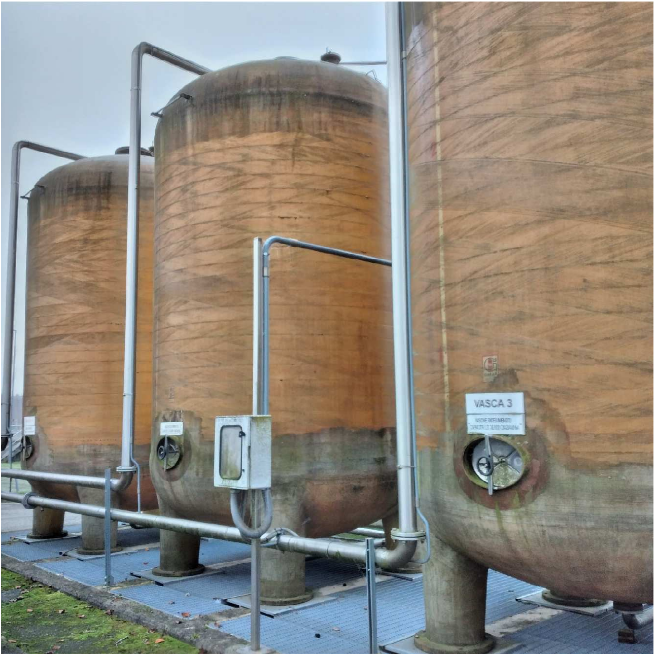
Zona S3: vasche di accumulo (silos)
