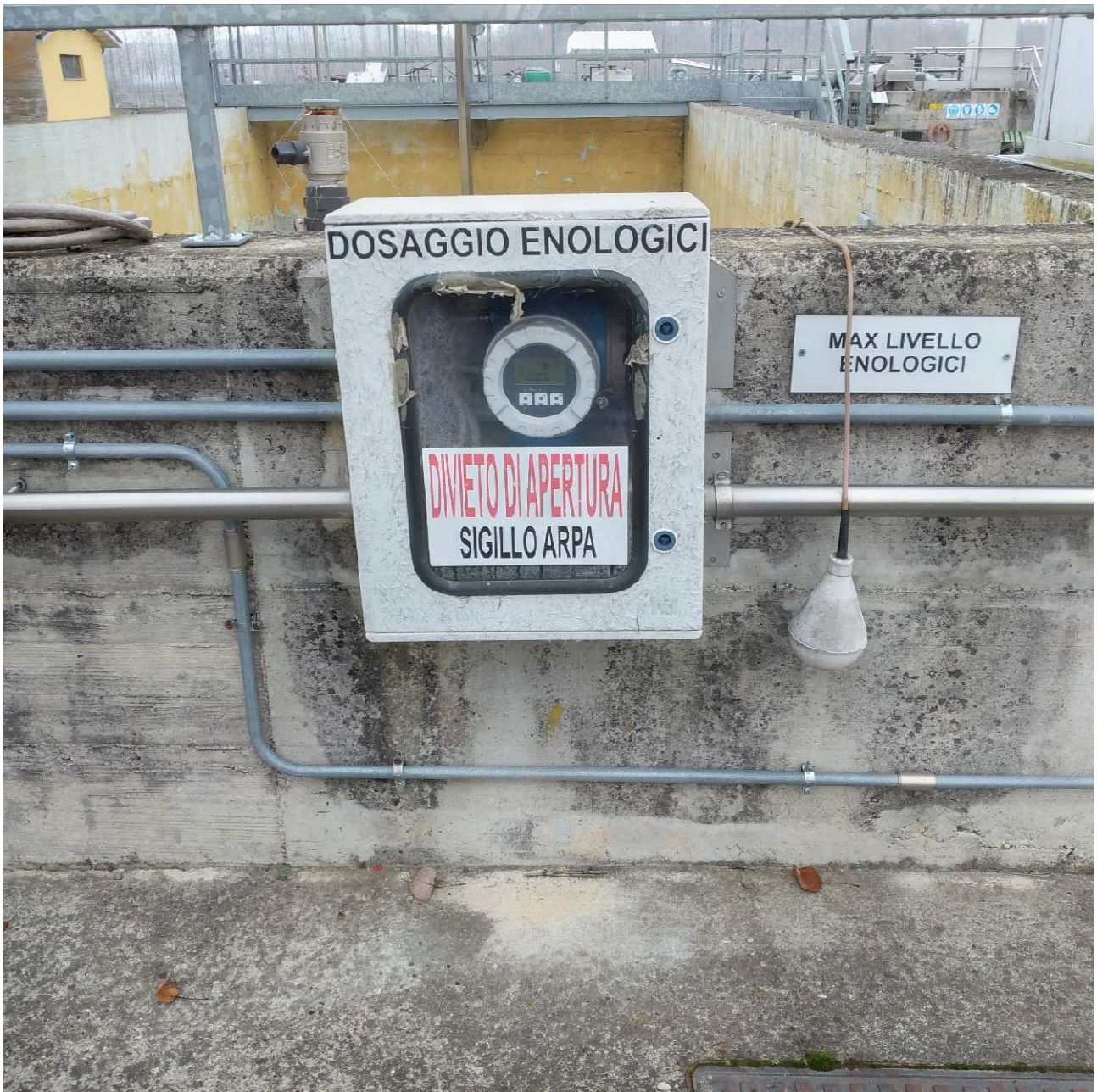
Zona S3: misuratore di portata sigillato da A.R.P.A.
