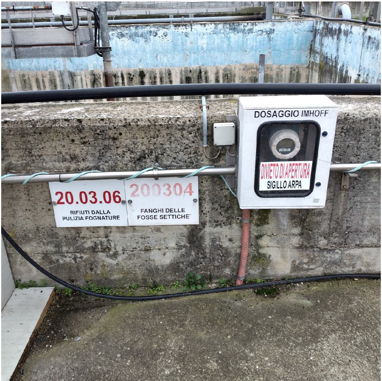
Zona S1: misuratore di portata sigillato da A.R.P.A.
