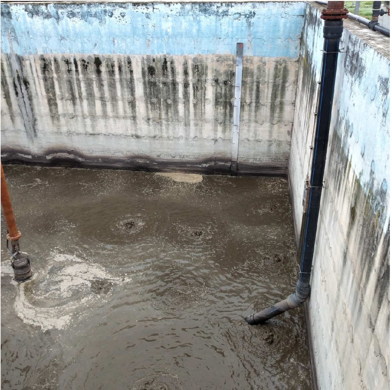
Zona S1: vasca di omogeneizzazione aerata
