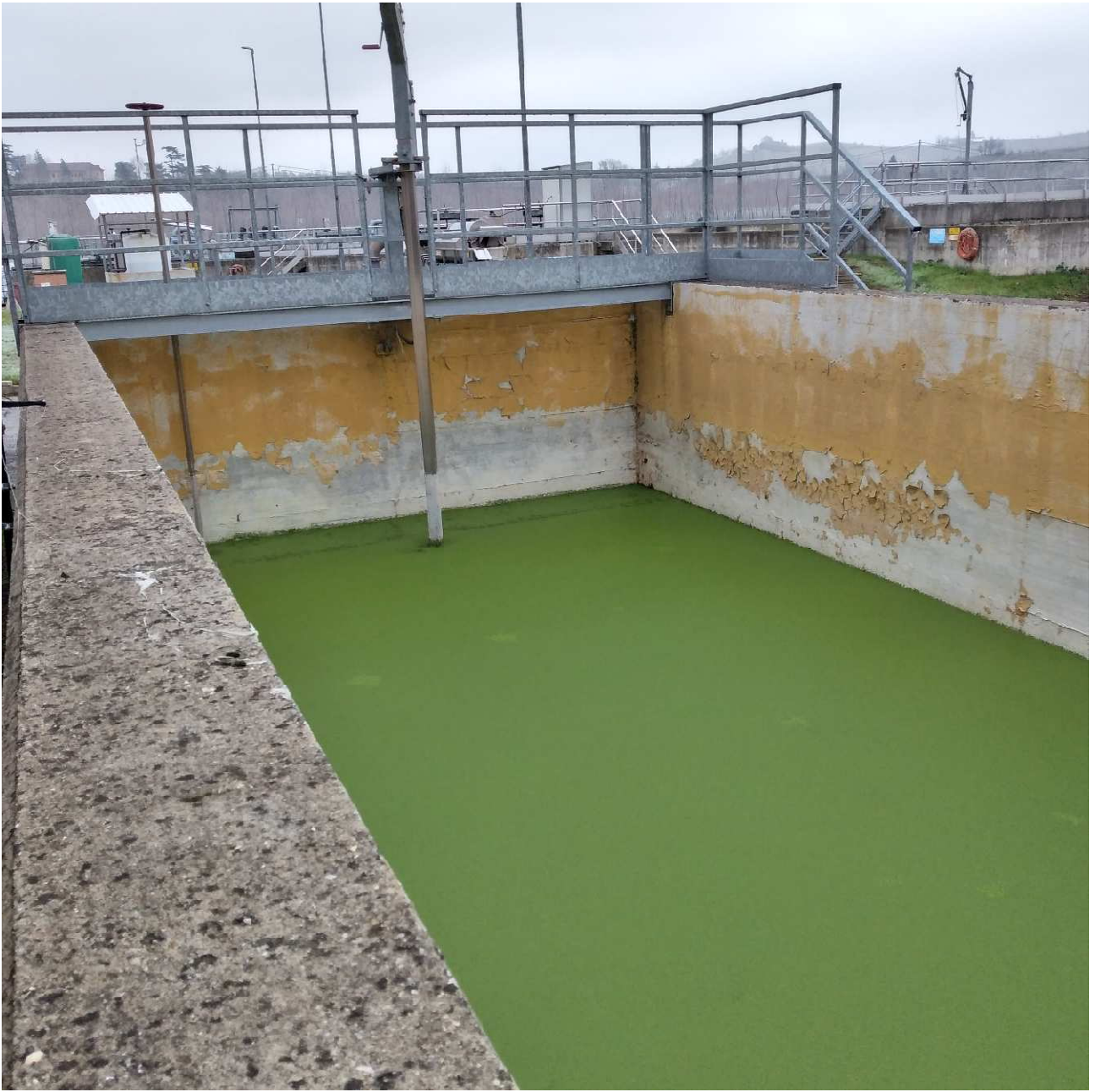
Zona S2: vasca stabilizzazione fanghi
